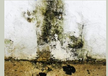
Stachybotrys atra _manchas de humedad_conidio_ascomycota
