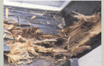
Pudrición Blanca en vigas en servicio
