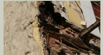
Pudrición Blanca en piezas en servicio
